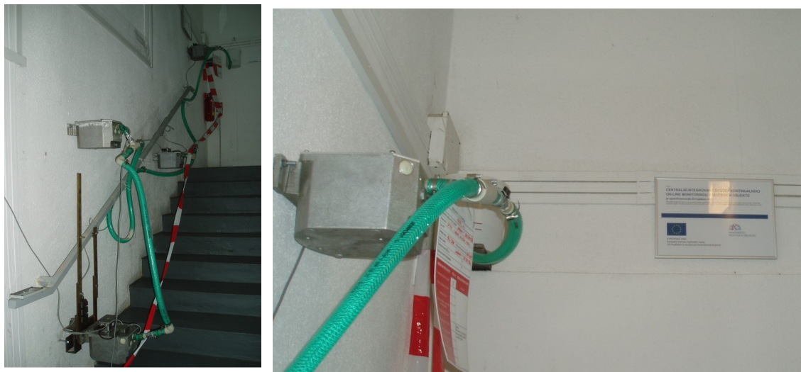
Obr. 5 a 6 Čidlo HINIV3 upevněné na stěně pro ověřovací měření
